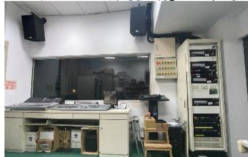
圖2-10-182 演藝廳控制室-增設設備後
