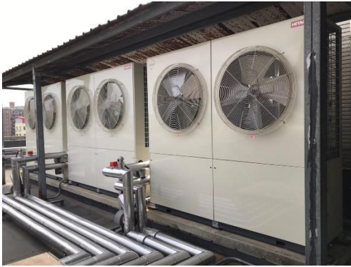
圖2-10-43 四樓閱覽區空調新主機
